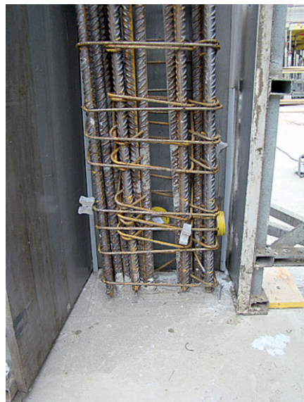
Bild 5 Beispiel für den Einsatz von Monitoringsystemen beim Neubau von Betonbauwerken
