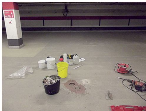
Bild 4 Beispiel für den Einsatz von Monitoring Systemen bei der Instandsetzung von Betonbauwerken:
