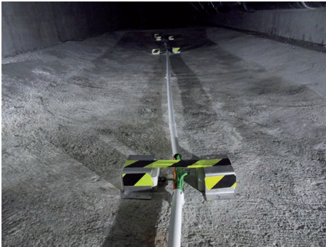
Bild 6 Fertig montiertes Schwellwert-Überwachungssystem
